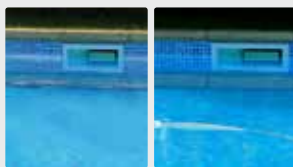
Linia osadu na ścianie basenu
