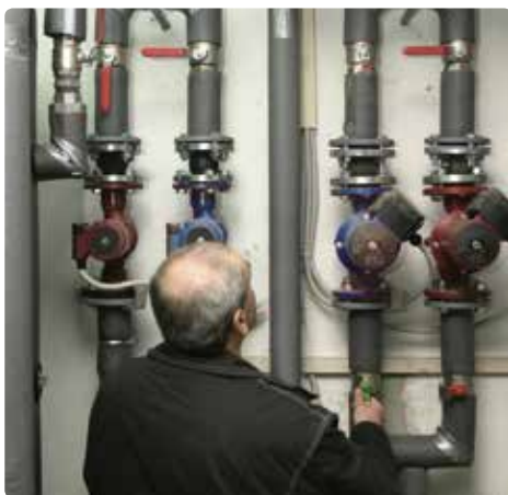
Rurociąg w budownictwie mieszkalnym
